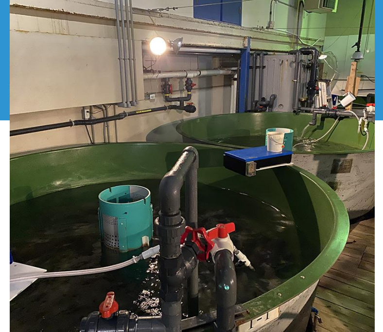
Salle des bassins
